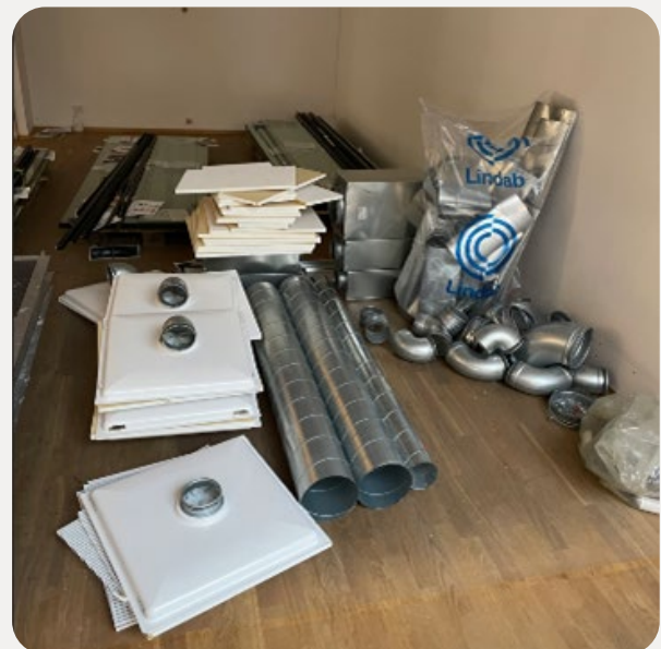
Demonterte deler til ventilasjonanlegget
