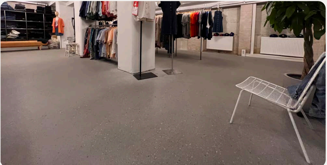
Slipt betonggulv på grunn
