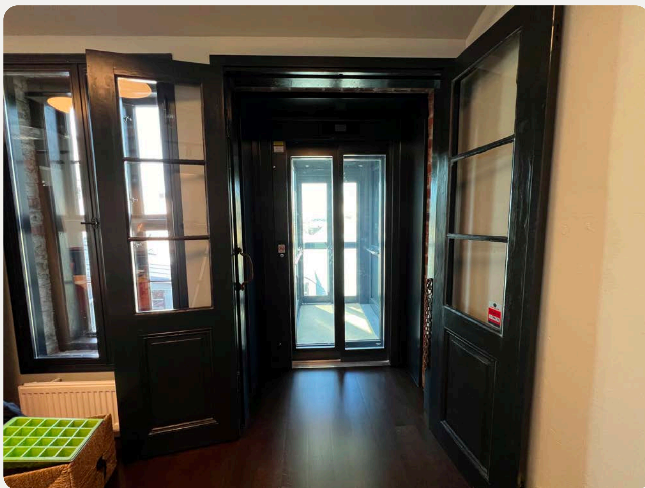
Restaurerte dører i heisåpning
